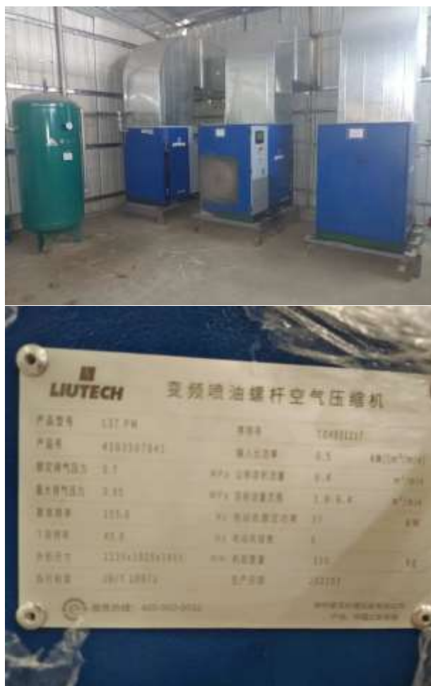
1 台 37kW 永磁電機及變頻的空氣壓縮機
